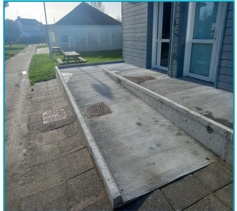
Rampe d'accès et éclairage extérieur Ty Golfe
